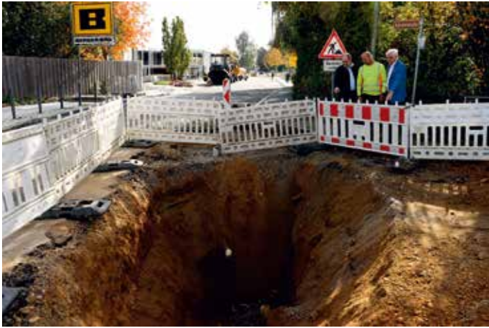
Bürgermeister Manfred Hammer (re.), technischer Bauamtsleiter Stephan Zitzlsberger (li.) und Matthias Reindl (Mi), Vorarbeiter der Firma Berger bei der Begutachtung der Ausmaße des Kanaleinbruchs. (Foto: Brunner)
