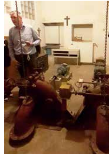
Turbinenraum des Kraftwerks mit zwei Einläufen.
